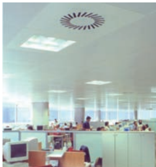
La renovación de aire es una de las principales necesidades para garantizar una calidad de ambiente interior.
